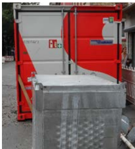
Brandschutzzeichen, Standort Feuerlöscher sowie Rettungszeichen Erste Hilfe aus ASR A1.3 an einem Baucontainer – aber bitte nicht zustellen! (Zl: SAM_2136 – Zuschnitt)
