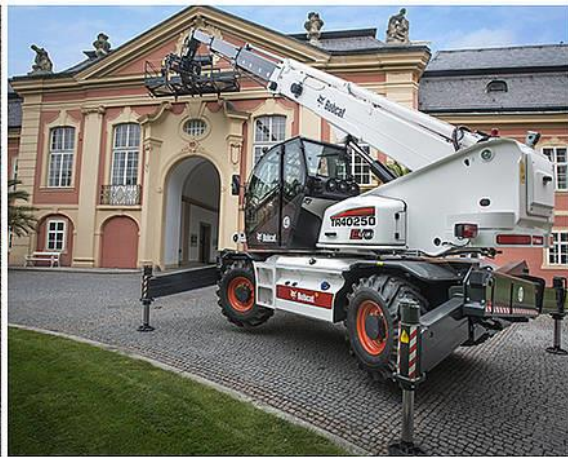
Teleskopstapler mit drehbarem Oberwagen – hier ausgerüstet mit einer Arbeitsbühne für sichere Höhenarbeiten an einem historischen Gebäude (Bobcat).
