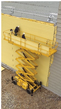
Bestimmungsgemäßer Einsatz für das Heben von Personen auf Baustellen: eine Hubarbeitsbühne – hier Scherenbühne. (Haulotte: H12SXL)
