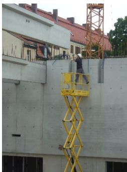
Verbotenes und bestimmungswidriges Besteigen der Zwischenstrebe einer Hubarbeitsbühne und damit Absturzgefahr des Bedieners.
